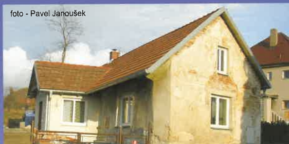
foto před opravou
