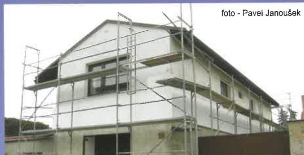
foto před opravou
