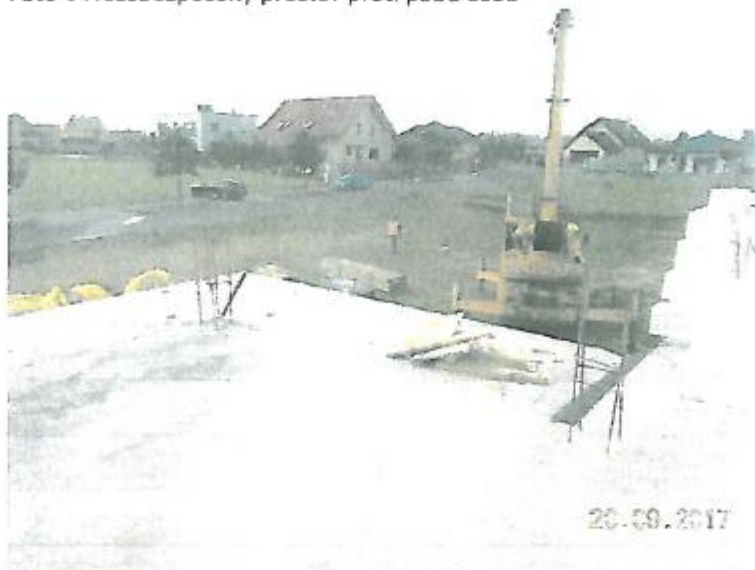
Foto 6 Nezabezpečený prostor proti pádu osob
